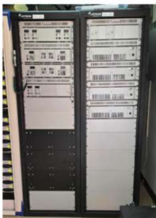
• Racks de Radios y Amplificadores Instalados en el Shelter
