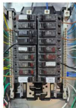
• Breakers para alimentación de Racks de Radio
